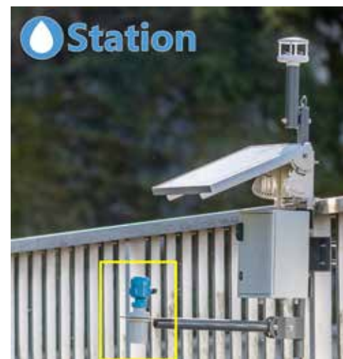
Station hydrologique Ogoxe installée sur un pont © OgoXe
